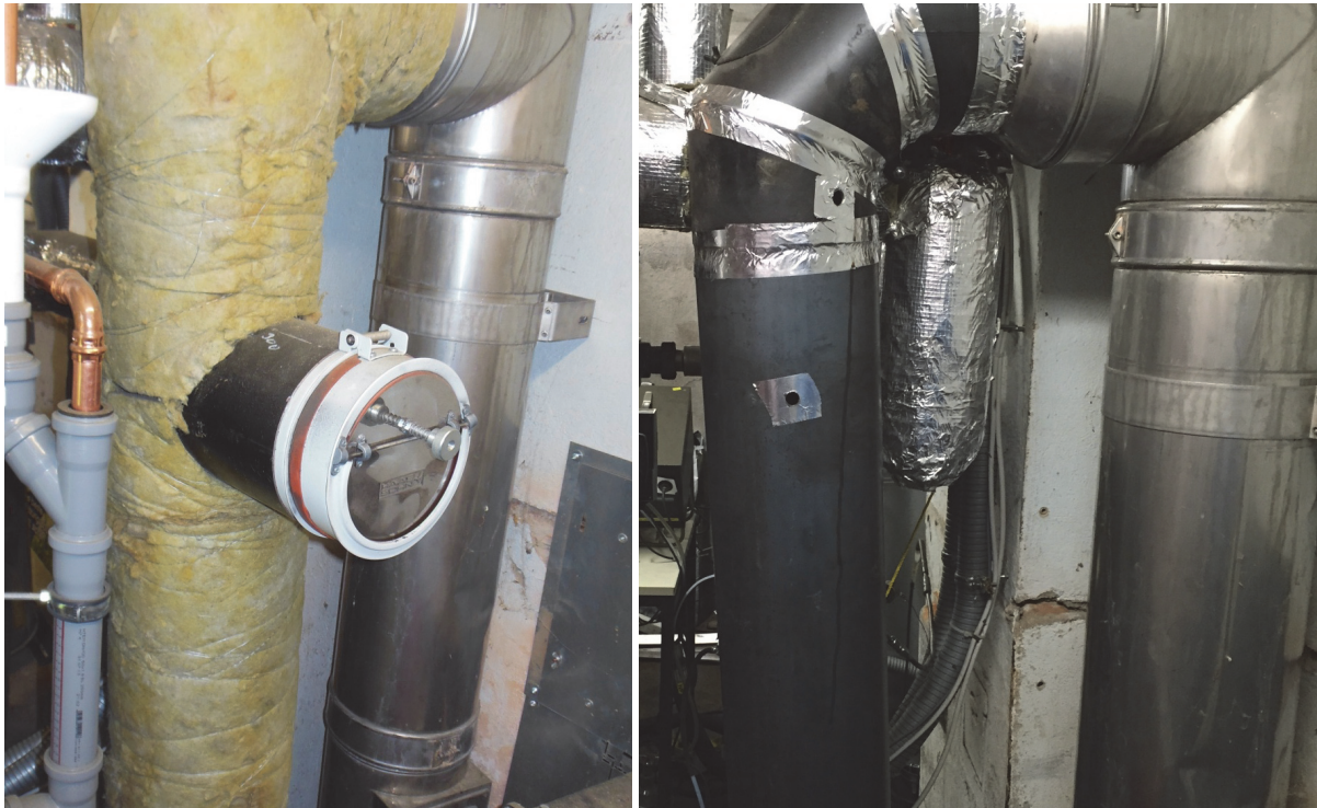
Abbildung 9: Vorhandenes wärme gedämmtes Rauchrohr mit Zugbegrenzer (links); Neu eingepasstes Rauchrohr (ohne Wärmedämmung) mit Bohrungen für die Messsonden der Abgasanalytik (rechts)
