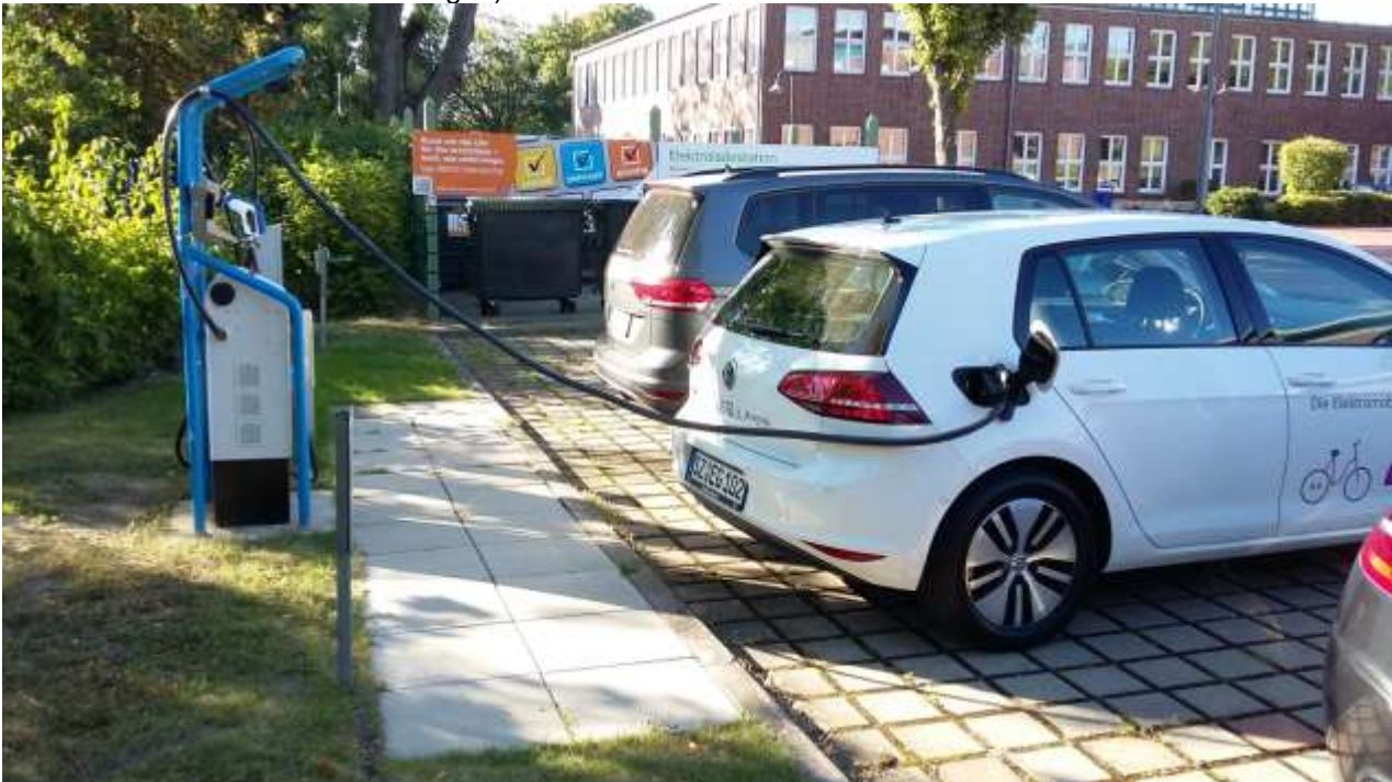
Abbildung 24: Kabel an den Ladesäulen recht kurz (Ladesäule an der Ostfalia in Salzgitter)
