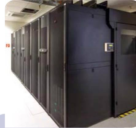
Warmgangeinhausung im Maschinenraum des Rechenzentrums
